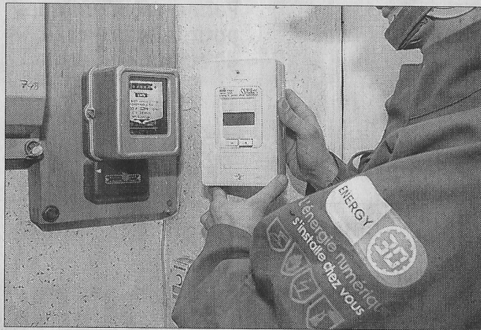
Linky, le nouveau compteur électrique communicant d'ERDF, devrait remplacer à terme l'ancien compteur électrique bleu. Une décision qui divise. Photo L'Alsace/Thierry Gachon
